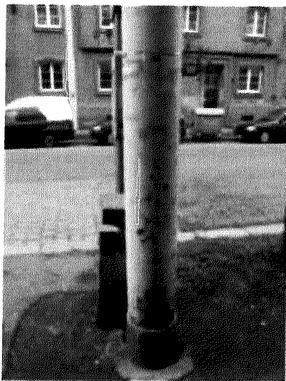
20% koroze do výše 2.5. m - Střední koroze
